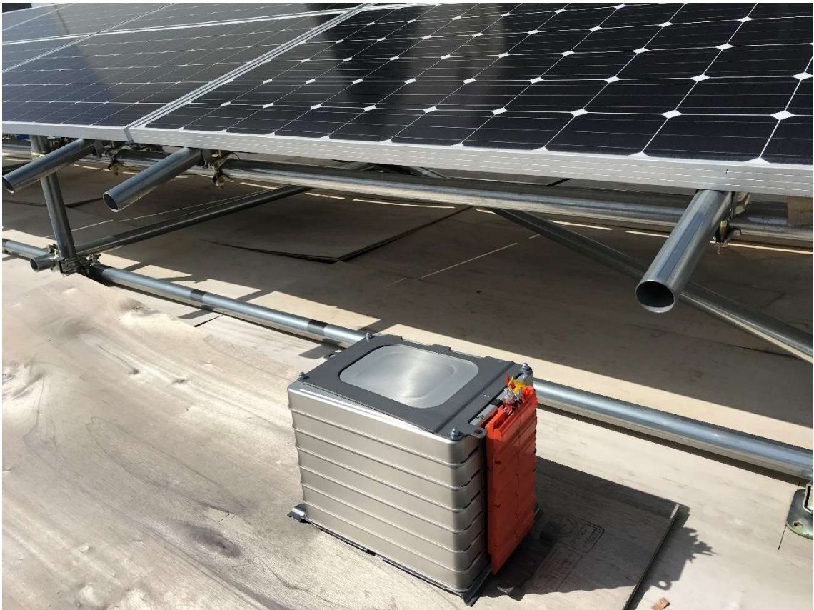
太陽光パネルと車載用リユースバッテリー
