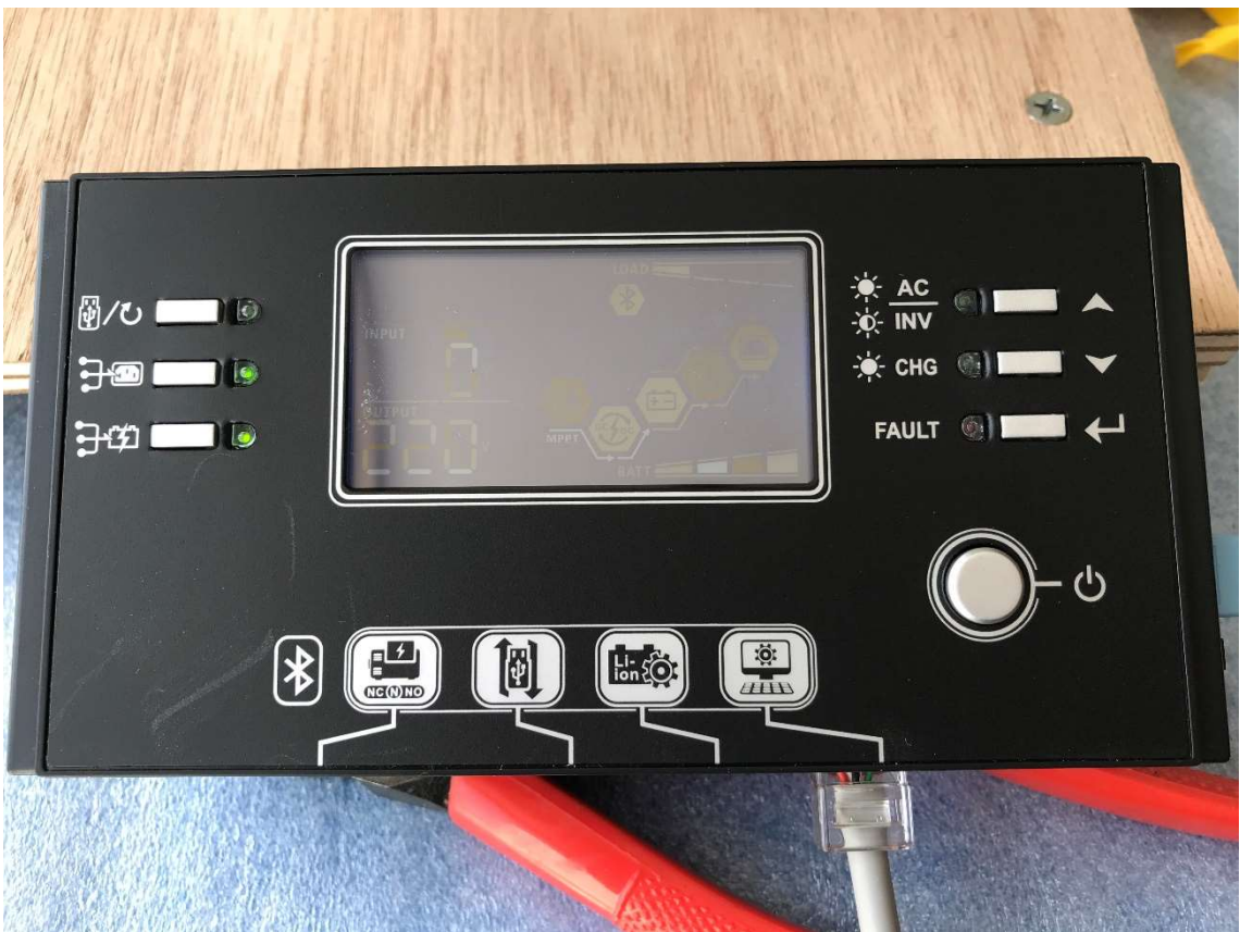
パワーコンディショナー操作パネル
